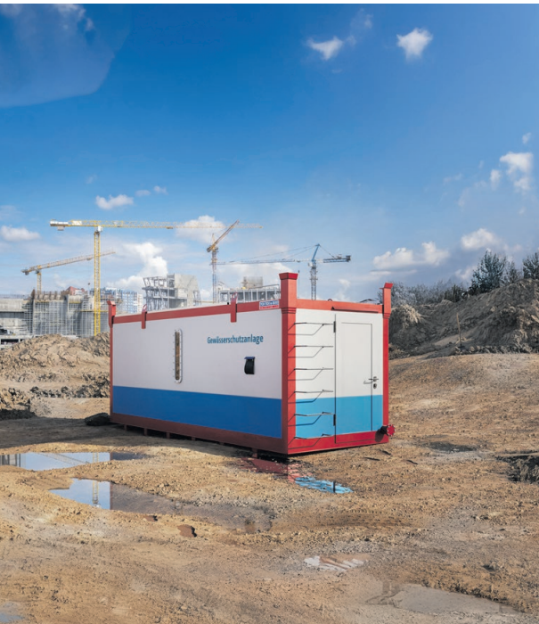
Mobile Gewässerschutzanlagen erleichtern das umweltschonende Abwassermanagement auf Baustellen.
