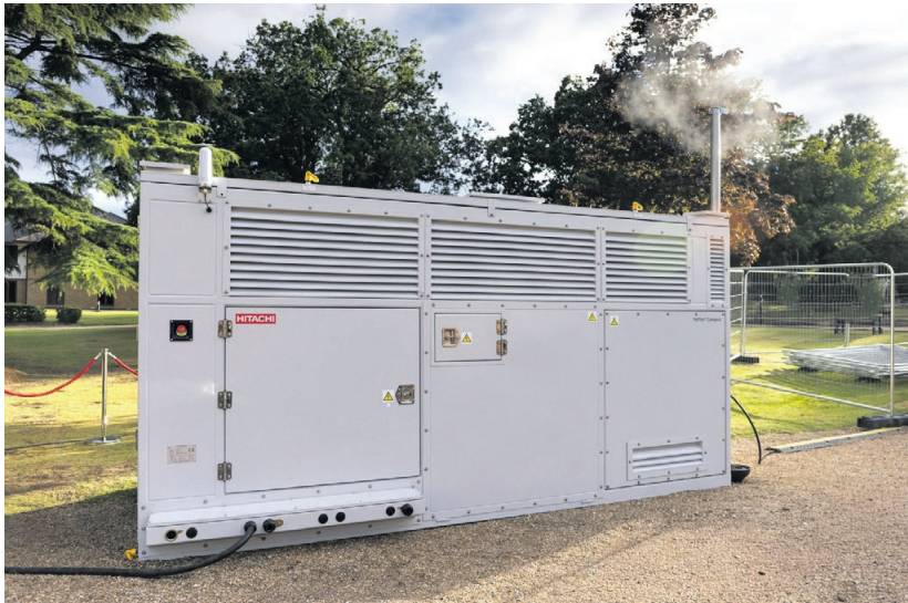
Beim HyFlex Compact handelt es sich um einen Hybrid-Generator, der emissionsfreien Strom für temporäre und netzunabhängige Anwendungen bereitstellt.
